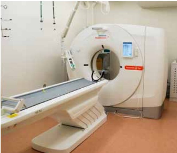
装置更新後のまちなか病院CT室
